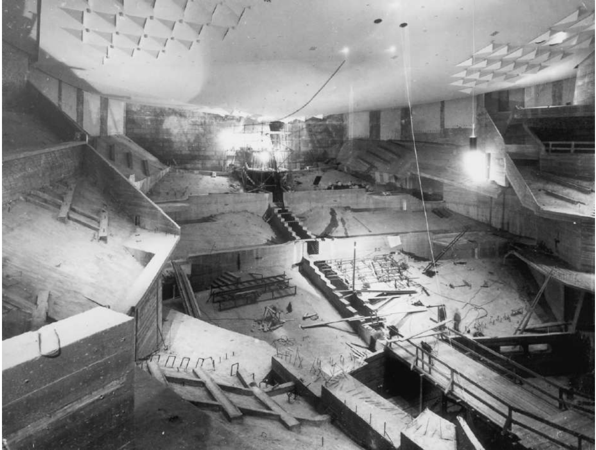
FIGURA 02 » Reinhard Friedrich. Grosse Sall im Bau. La gran sala en construcción. Archiv Berliner Philharmoniker
